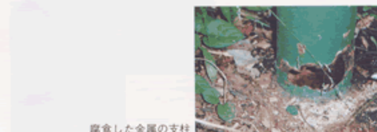
腐食した金属の支柱
